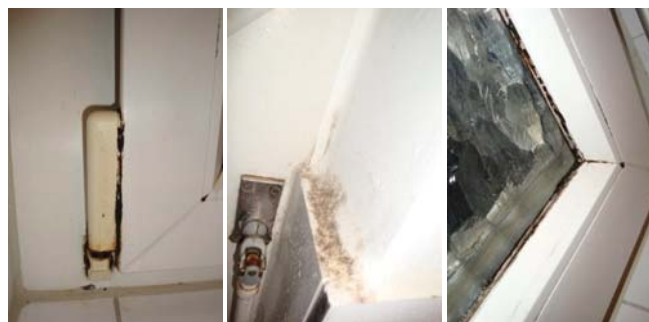
Schimmelbefall in einer Wohnung 16 Monate nach der Erneuerung Küche/Bad Hofgarten I-II
